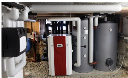
Für den Ersatz einer fossilen Heizung durch eine Sole-Wärmepumpe (Bild) spricht der Kanton Fördergelder.
